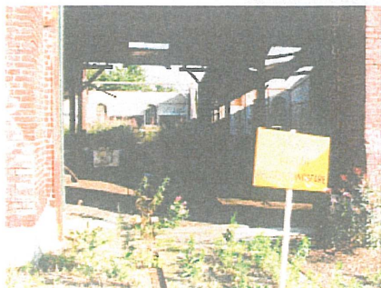
Tølløse Remise. Der ses tydelige sætningsskader i murværket. De er opstået delvis p.g.a. manglende vedligehold, dels som følge af en tidlig, nødvendig udvidelse af vognportene, stormskade og vejrligets indhug. Fot.: Peter Sørenius 05.08.2009.
